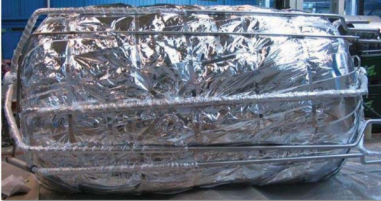
Mit MLI umwickelter Flüssiggastank ohne Außenhülle. Chart-Ferox [2]
