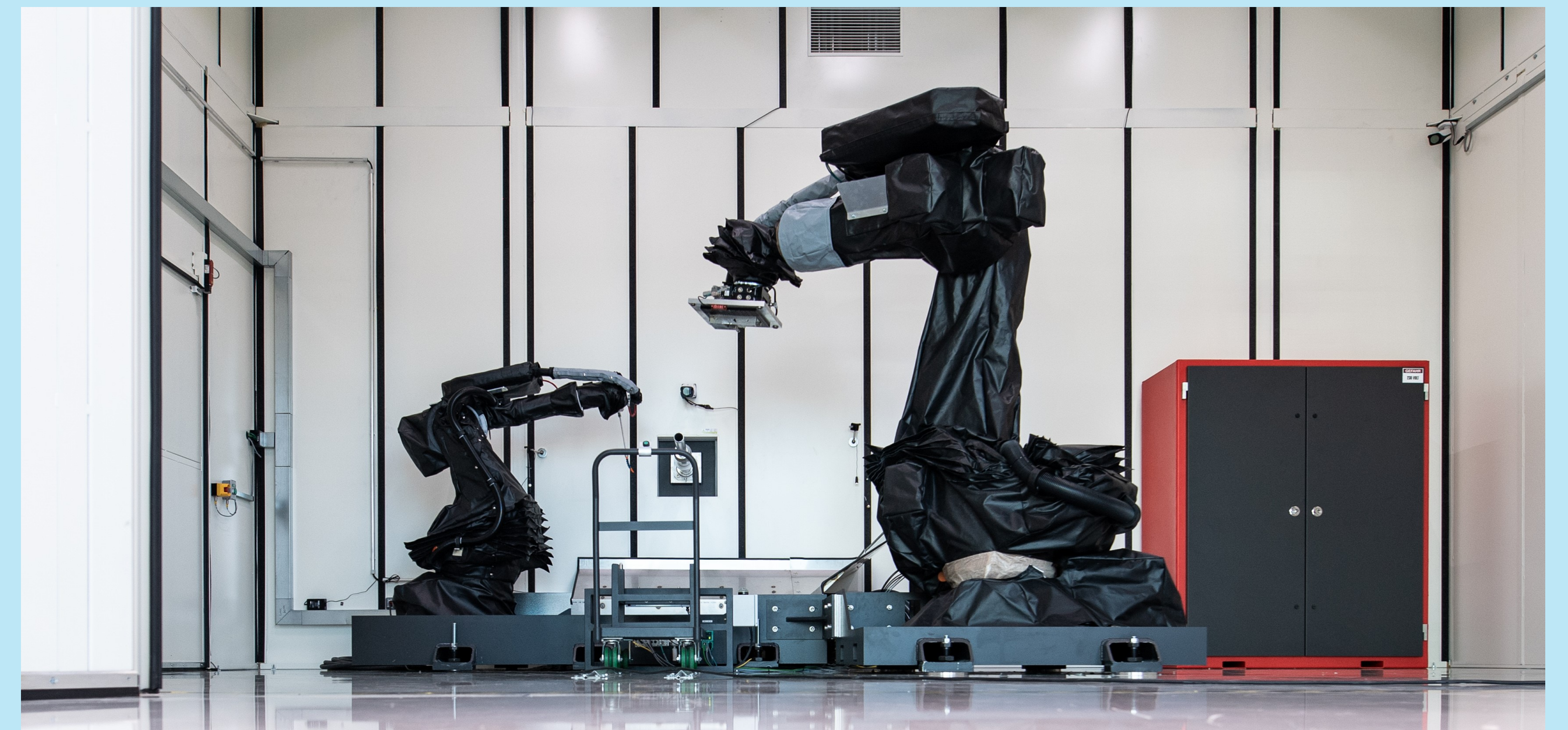
Abb. 2: Laser-Shock-Peening-Anlage @ ZAL TechCenter
