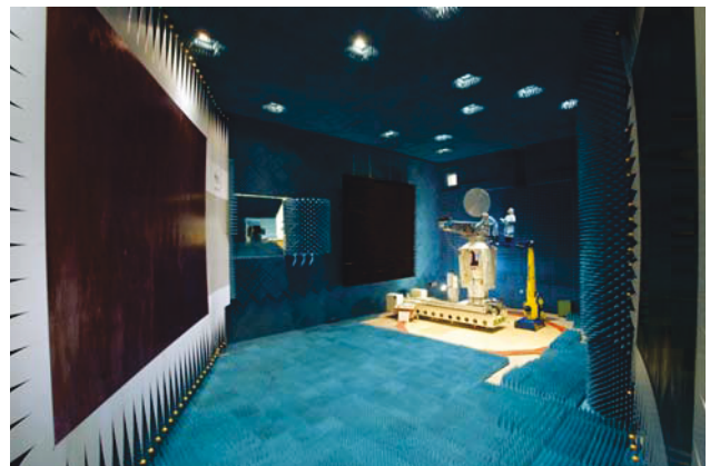
BILD 15: Compact Range Antennenmesskammer
